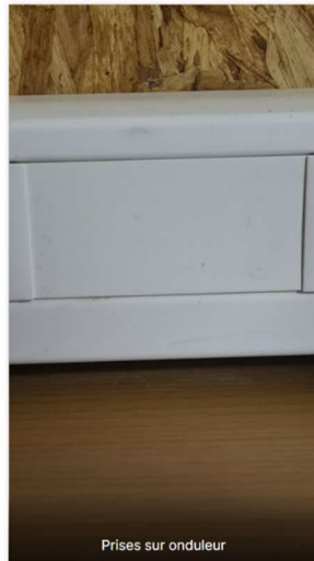
Prises sur onduleur
